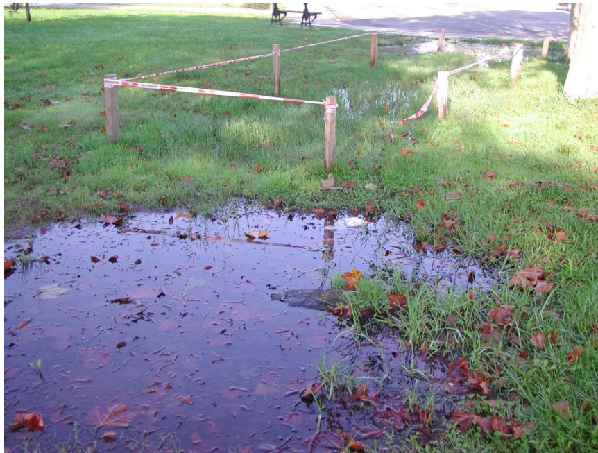
Perdida de agua potable en Plaza de San Juan
